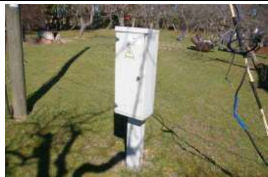
Zemes gabals ar kadastra apzīmējumu 6448 010 0020, elektrosadales un uzskates skapis
